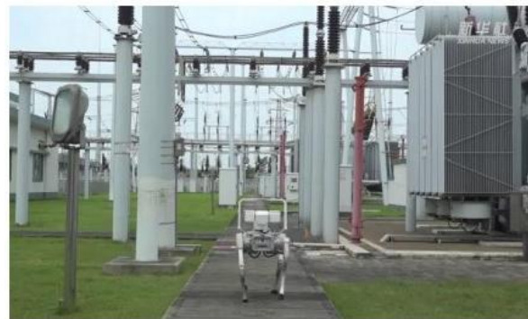
纪南变电站智能巡检
