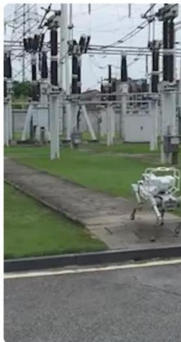
纪南变电站智能巡检
