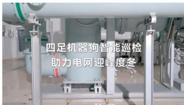
江苏某变电站巡检
