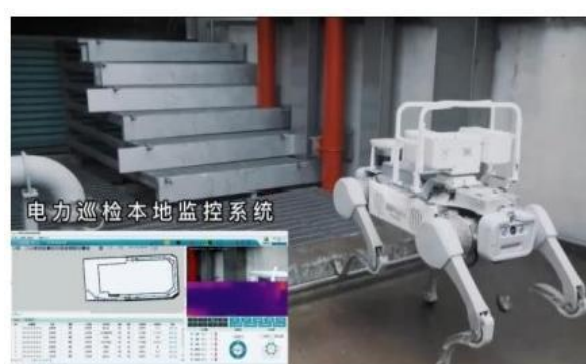
浙江某换流站巡检
