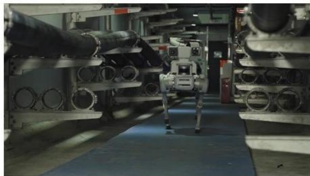
杭州亚运村电力管廊
